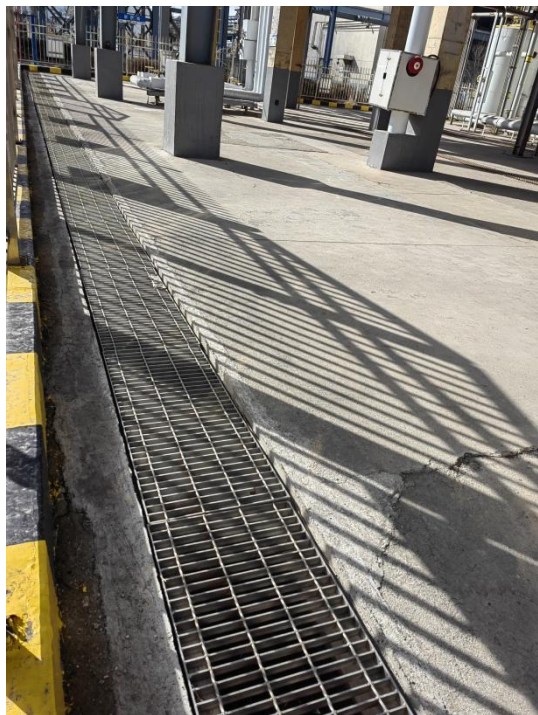
氨区事故排水沟
