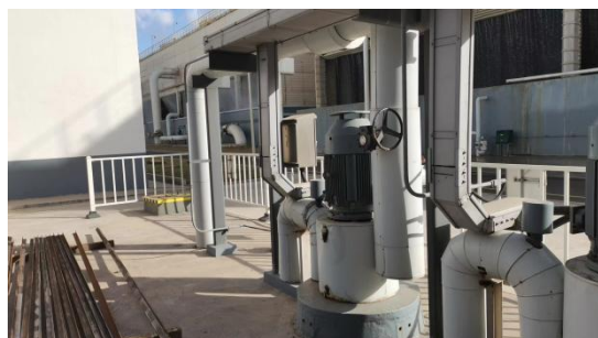
纯水站中和水池
