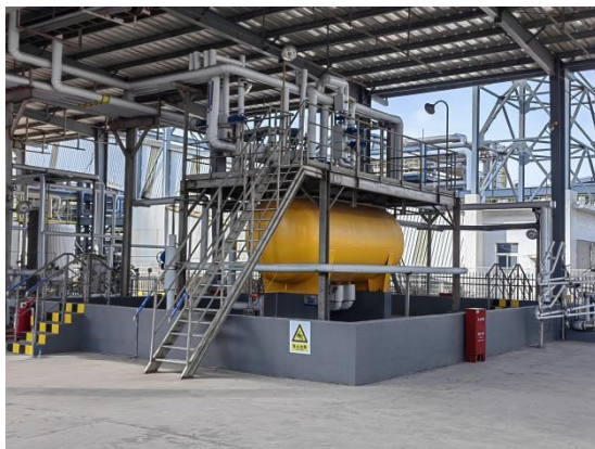
a. 液氨缓冲罐区遮阳棚及喷淋装置
