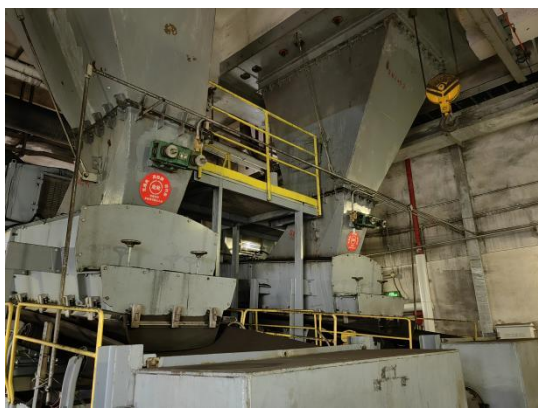
管带输送机喷雾抑尘
