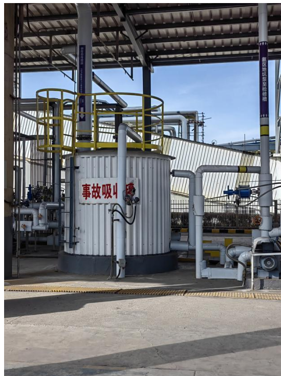
氨区事故吸收管
