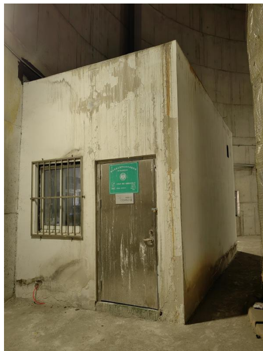
CEMS站房（外部）
