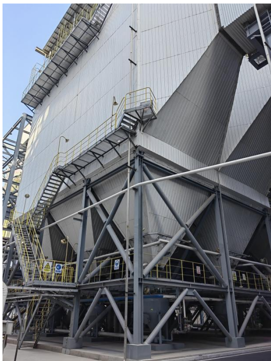
7#锅炉电除尘器
